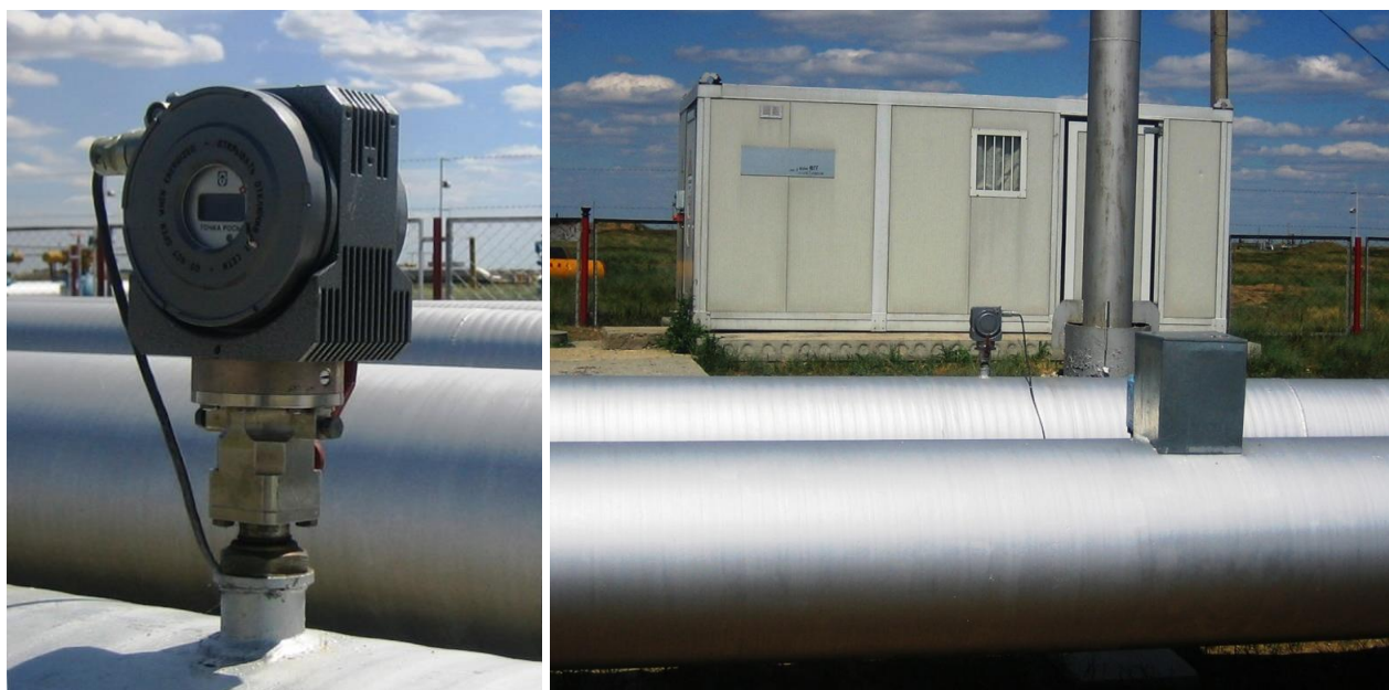
Рисунок 2. - Внешний вид установки анализатора на ГИС
